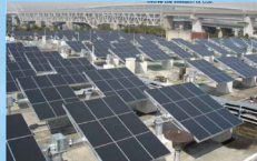
▲太陽光パネル (葛西水再生センター)
