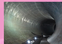
▲和田弥生幹線 日本最大級の雨水貯留施設 25mプール約500杯分の雨水を ためることができます
