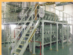
▲非常用発電機 (北多摩一号水再生センター)
